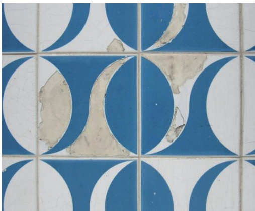
Figure 3: Detail of decay at Av. Rainha Dona Amélia Nº 50, Lisbon
