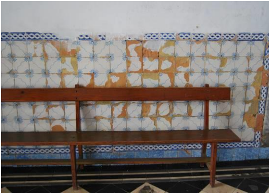
Figura 1a- Perda de vidrado a partir dos cantos e arestas sem eflorescência de sais (Hospital da Misericórdia, Beja. Data de inspeção: Janeiro 2013).
