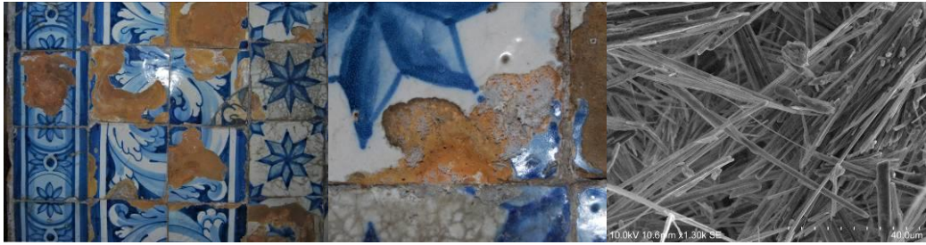
Figura 3a- Perda de vidrado ao centro e arestas, sem danos na chacota. Capela de Nossa Senhora dos Remédios, Peniche. Data da inspeção: Julho 2013
