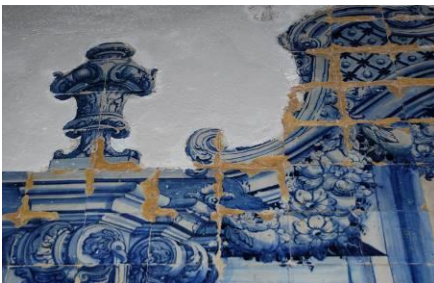
Figura 2a- Perda de vidrado e chacota a partir das arestas no topo do painel (Mosteiro de S. Bernardo, Portalegre. Data da inspeção: Janeiro 2013).
